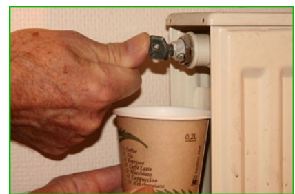
Bild 6 Om inte radiatoren blir varm upptill är det dags för luftning. Om den fortfarande är kall är det dags att ringa "felanmälan".
