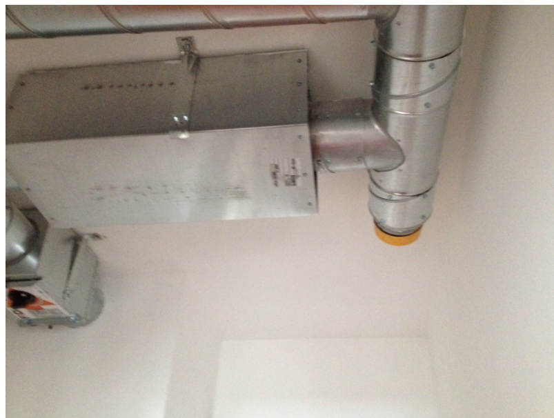
Figur 5. Kanaldragning för FTX-aggregat vertikalt i klädkammare i hallen.
