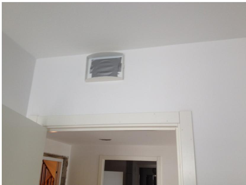
Figur 7. För att göra plats för kanaldragning sänks innertaket i hallen max 20 cm. Takhöjden sjunker från 2,5 till 2,3 m.
